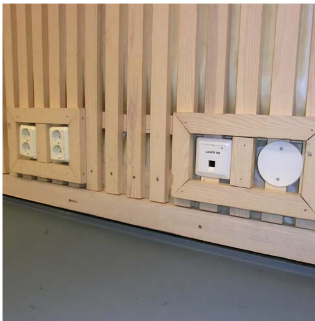
Beskyttelse av elektriske installasjoner Foto: Morten Roa
