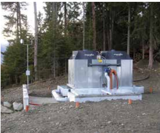
Et kjøletårn senker temperaturen i vannet for å bedre effektiviteten av snøkanonen ved marginale temperaturer.
