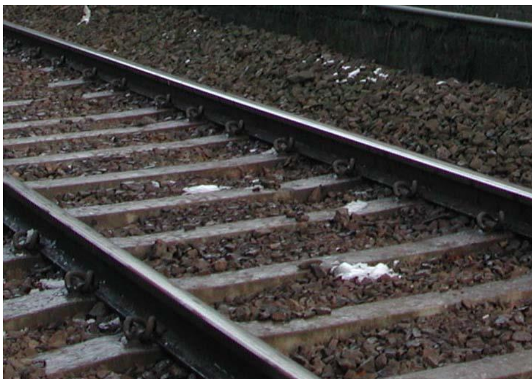
Figur 35: Skinetilstand har stor betydning for støyen. Foto: Miljødirektoratet
