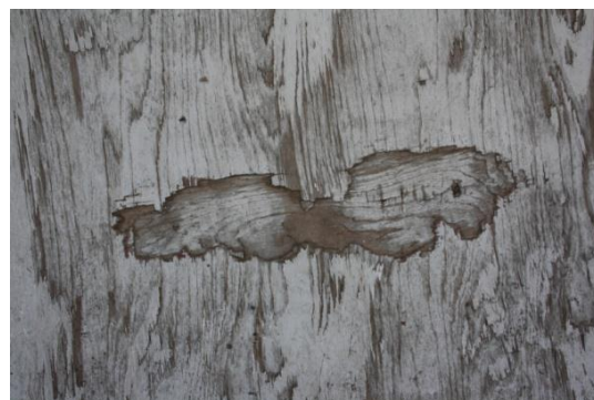
48: Skade midt på finerplate Foto: CD
