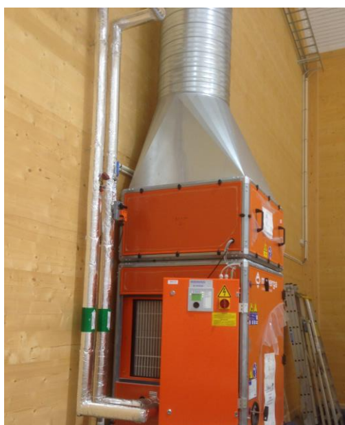
Figur 2: Avfukter levert av Menerga AS
