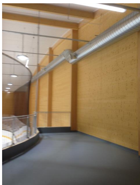
Figur 3: Tilførsel av avfuktet luft. Kanalføringen er fra motsatt side avbildet i Figur 1.
