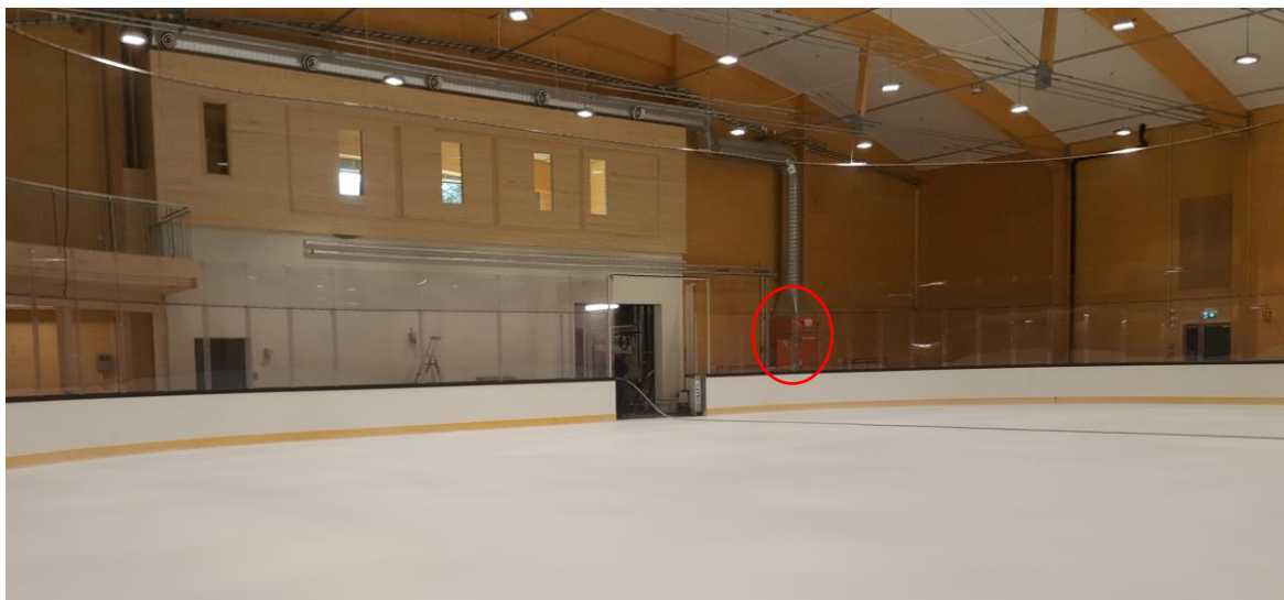
Figur 1: Plassering av avfukter
