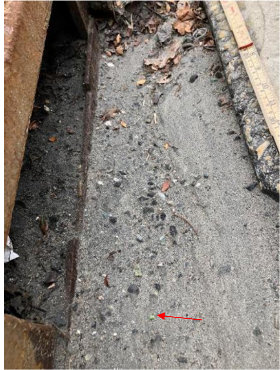
Avløpspunkt ved Stemmen 10. Synlig TPE granulat og annet plastavfall i nedløpet.
