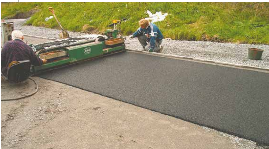
Utlekking av plaststøpt støtdempingssjikt (pad)
