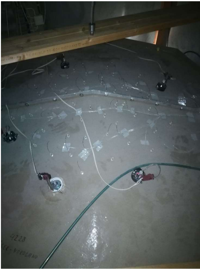
Foto 1 Bilde tatt av taket dampbadet, ingen isolasjon
