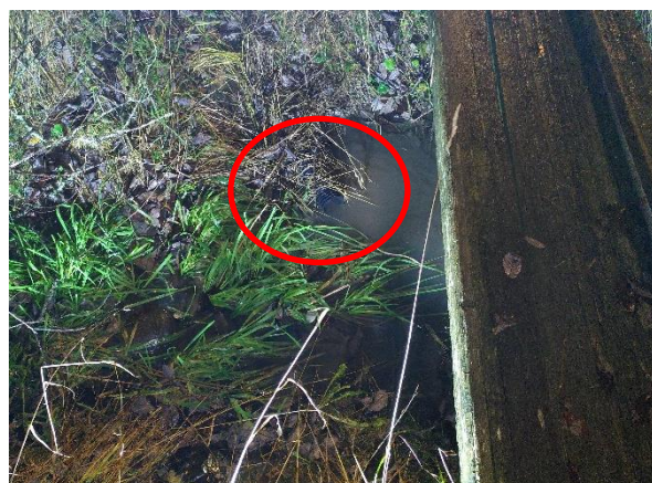
Bilde 8: Prøvetakingspunkt Ellingsrud 7 (rød sirkel), utløp av overvannsrør med retning fra kunstgressbanen. Utløpet ligger under vann. Bildet er fra prøvetakingsrunde 5, 16.11.2020
