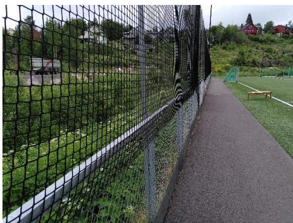
Bilde 29: Vestre langside av Granlybanen (Bekken går i grøft til venstre i bildet). Det er noe granulater på asfaltstripe. Ved netting er det montert plate nederst for å hindre spredning videre ut fra banen. Det er kun små mengder granulater utenfor nettingen. Bildet er fra prøvetakingsrunde 1, 23.6.2020
