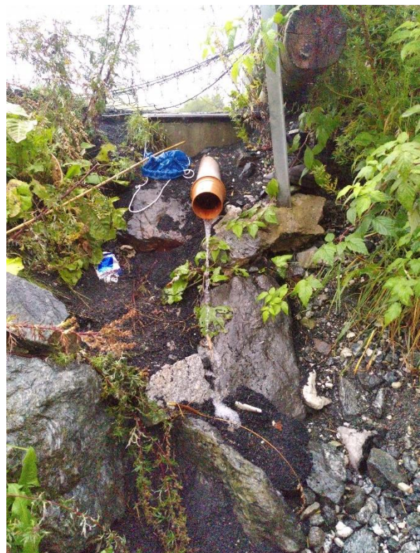
Bilde 58: Prøvepunkt Frogner 5 (overvannutløp for grunn kum). Det er observert granulater i vannet som kommer fra kummen. Bildet er tatt ved prøvetakingsrunde 2, 14.9.2020.
