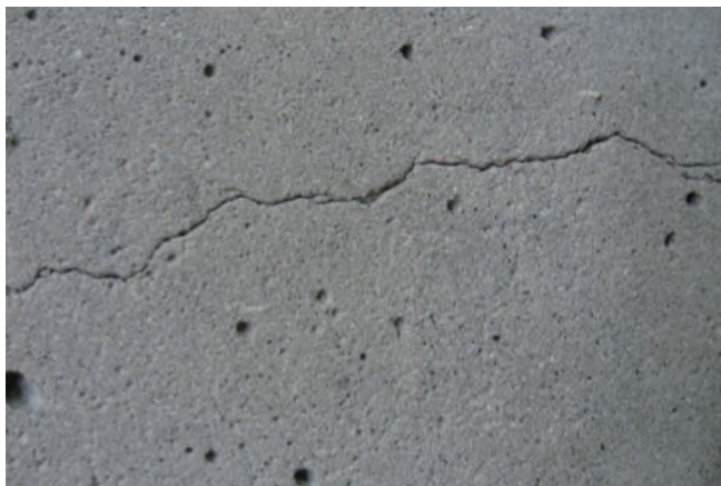
Figur 12: Sandblåsing kan avdekke både sprekker og hull i overflaten som lett kan være skjult av slamlag mot forskalingen. (Foto: NBKF)
