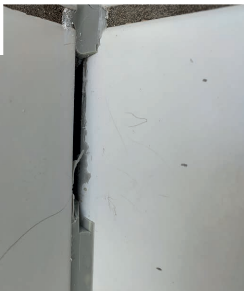
Under: Riktig utført hjørnefuge. Testen viste rensket hulrom under den elastiske fugemassen.
