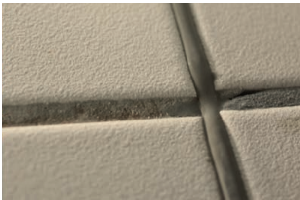
Figur 20: Eksempel på sammenpresset fuge grunnet relativbevegelse mellom underlag og flislag.
