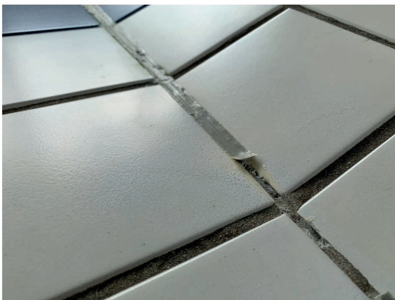
Over: Galt utført elastiske fuge vi bassengbunn. Ikke fritt hulrom under den elastiske fugemassen.
