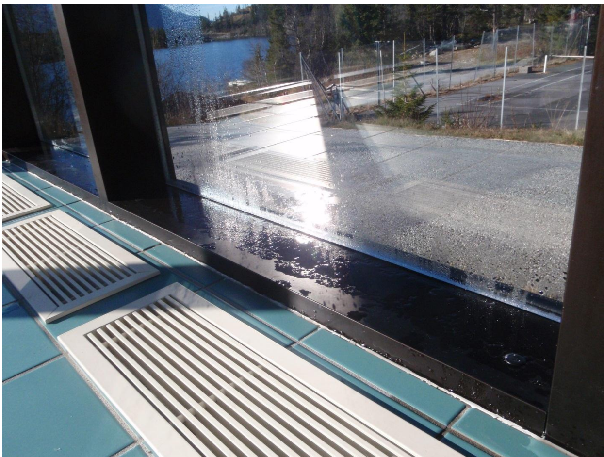
Figur 6. Kondens på innvendig vindusoverflate og karm grunnet dårlig U-verdi på konstruksjonsdelen og lav hastighet på innblåst luft. Foto: Hilde Drolsum Røkenes
