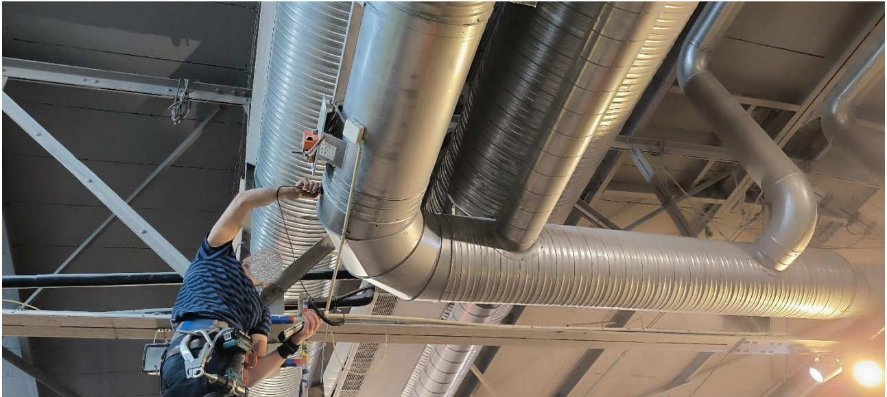
Figur 10. Måling av lufthastighet i tilluftskanal. Bilde tatt av Vladyslav Pankov
