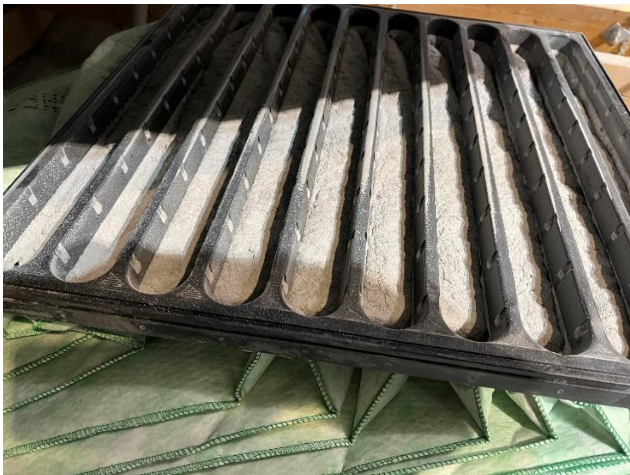
Figur 25. Tilstand til avtrekksfilter på Torshov. Isak Langeland
